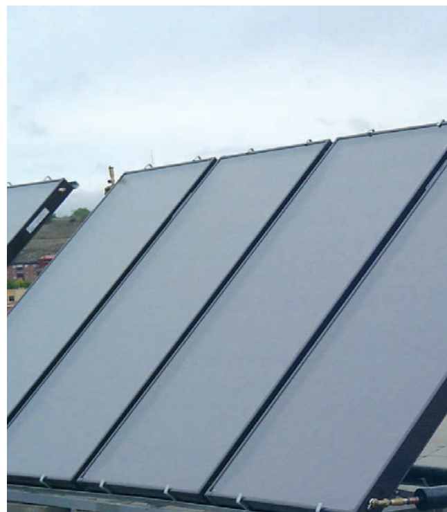
Instalación solar térmica en la cubierta de un comunidad.
